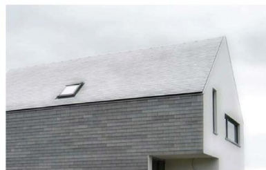
Plăci de fibrociment
